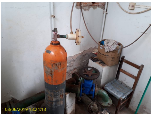
Foto 31 - Estrutura inadequada, dosagem de cloro junto com as bombas
