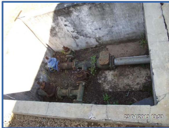
Imagem 12: Caixa dos registros de manobras da adutora de água tratada.
