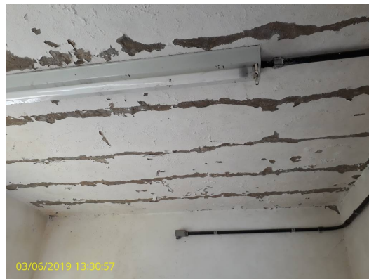
Foto 7 - Área interna em condições inadequadas de conservação
