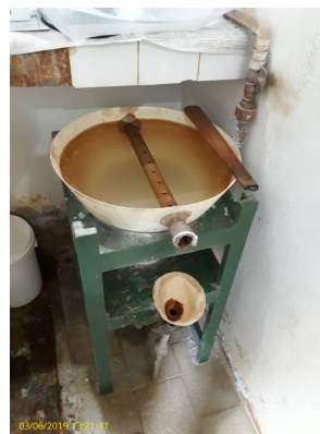
Foto 28 - Dosagem de flúor por tecnologia defasada
