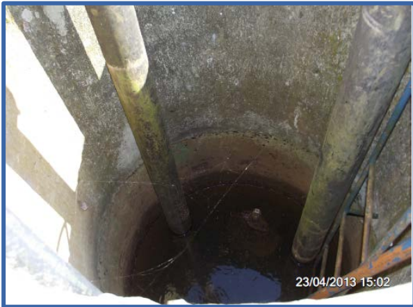
Imagem 10: Poço de sucção de água bruta.
