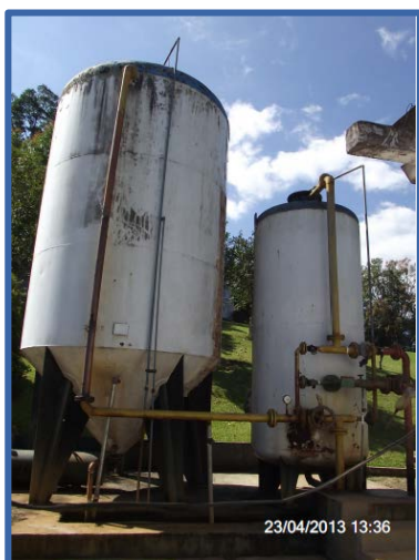
Imagem 16: Floccodcantador e filtro da ETA.
