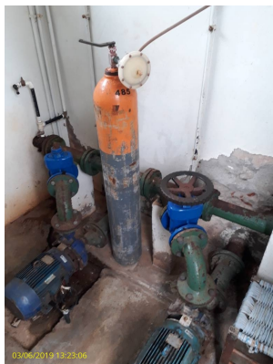
Foto 23 - Cilindro de cloro gás está instalado de forma improvisada
