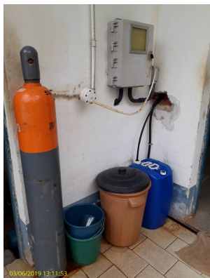
Foto 24 - Cilindro de cloro gás instalado de forma improvisada
