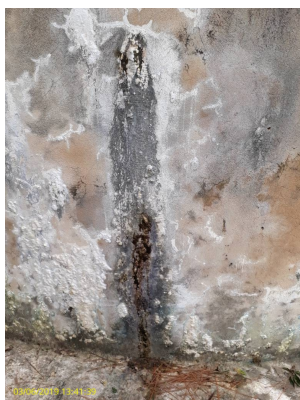
Foto 36 - Vazamento no reservatório
